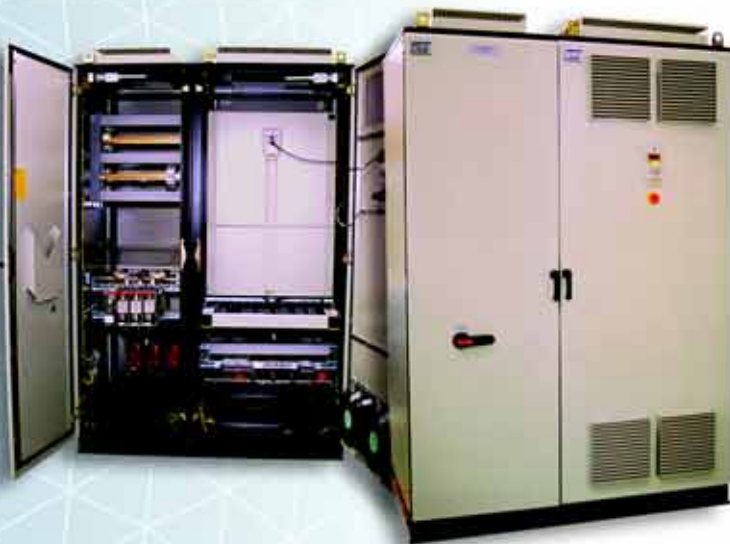
Convertidor de frecuencia 312A montado en tablero para accionamiento de motor de 200HP aplicado en cinta transportadora
