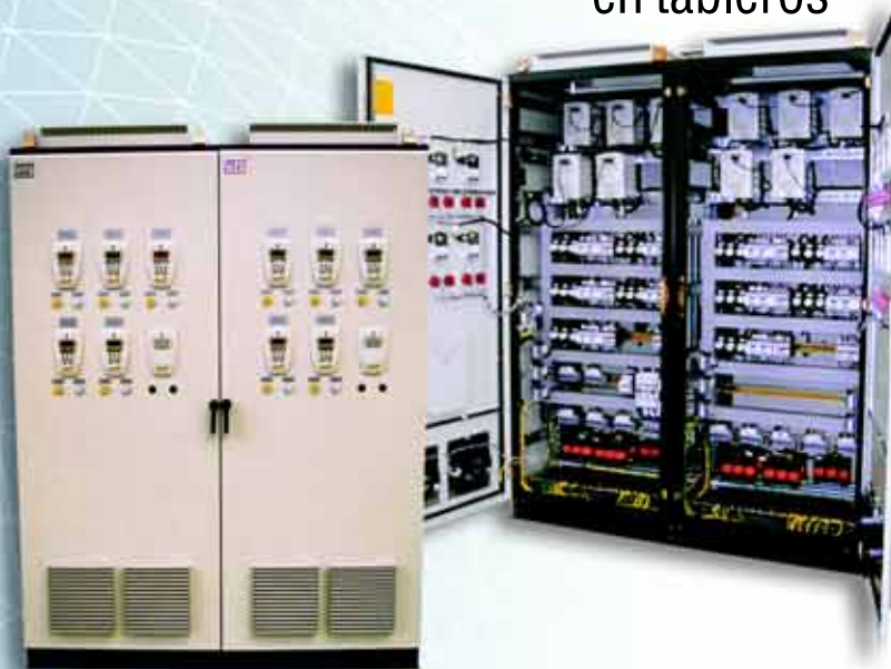
10 convertidores de frecuencia 9A montados en tablero para accionamiento de motores de SHP aplicados en dosificador de bagazo de caña de azúcar
